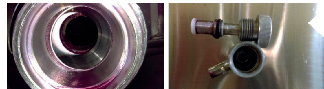
Photos 14 et 15 Démontage de 2 points critiques (vanne et dégustateur) avant procédure. (Crédit photo IFV 2018)
